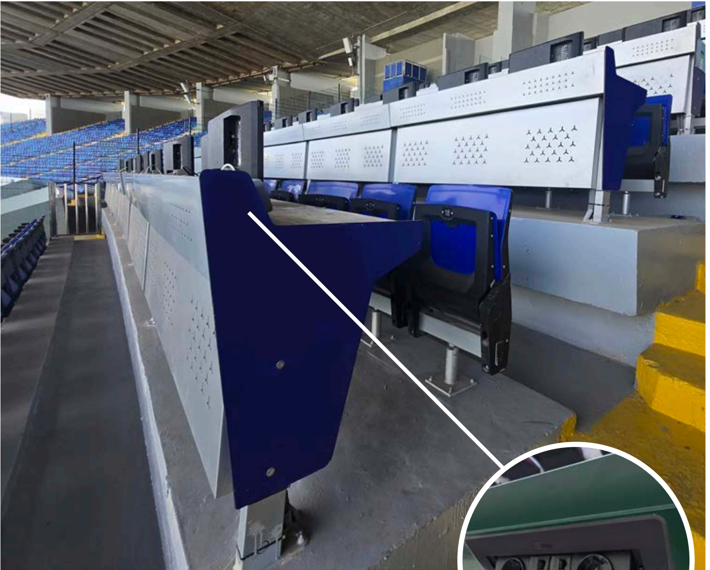
Predisposizione prese elettriche in vano a scomparsa
